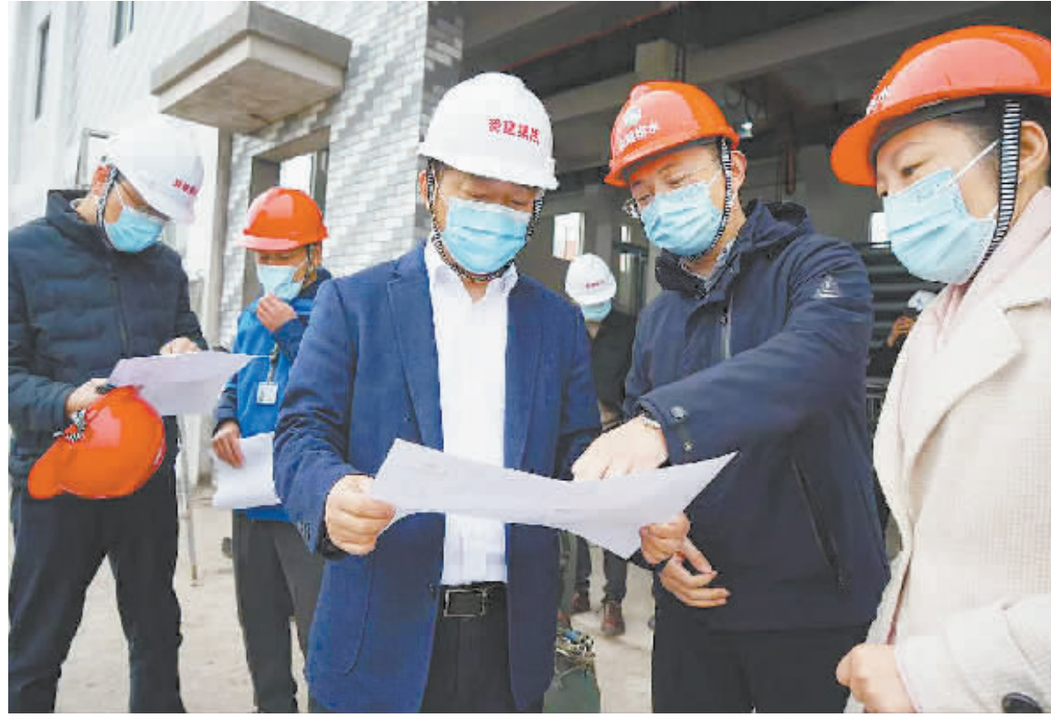
图为滨海再生工业水厂水质提标改造工程施工情况督查现场。
